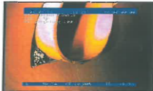
Fotografia: 7_1_7_06092012_112222_A.JPG 90,52m, 2.4 Allacciamento, 12 ore, non correttamente eseguito
