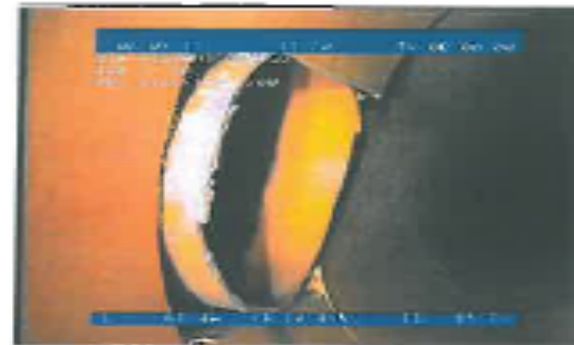
Fotografia: 7_1_8_06092012_112104_A.JPG 68,49m, 2.4 Allacciamento, 11 ore, non correttamente eseguito
