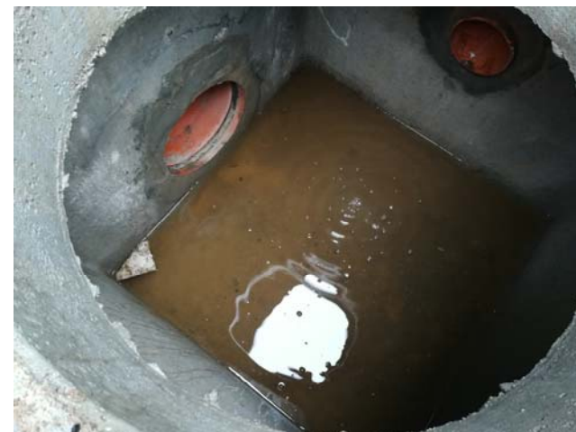
POZZETTO CON FONDO RIBASSATO E RISTAGNO DI ACQUE
